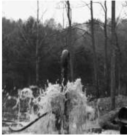
Perdite alla rete dell'acquedotto (archivio)
